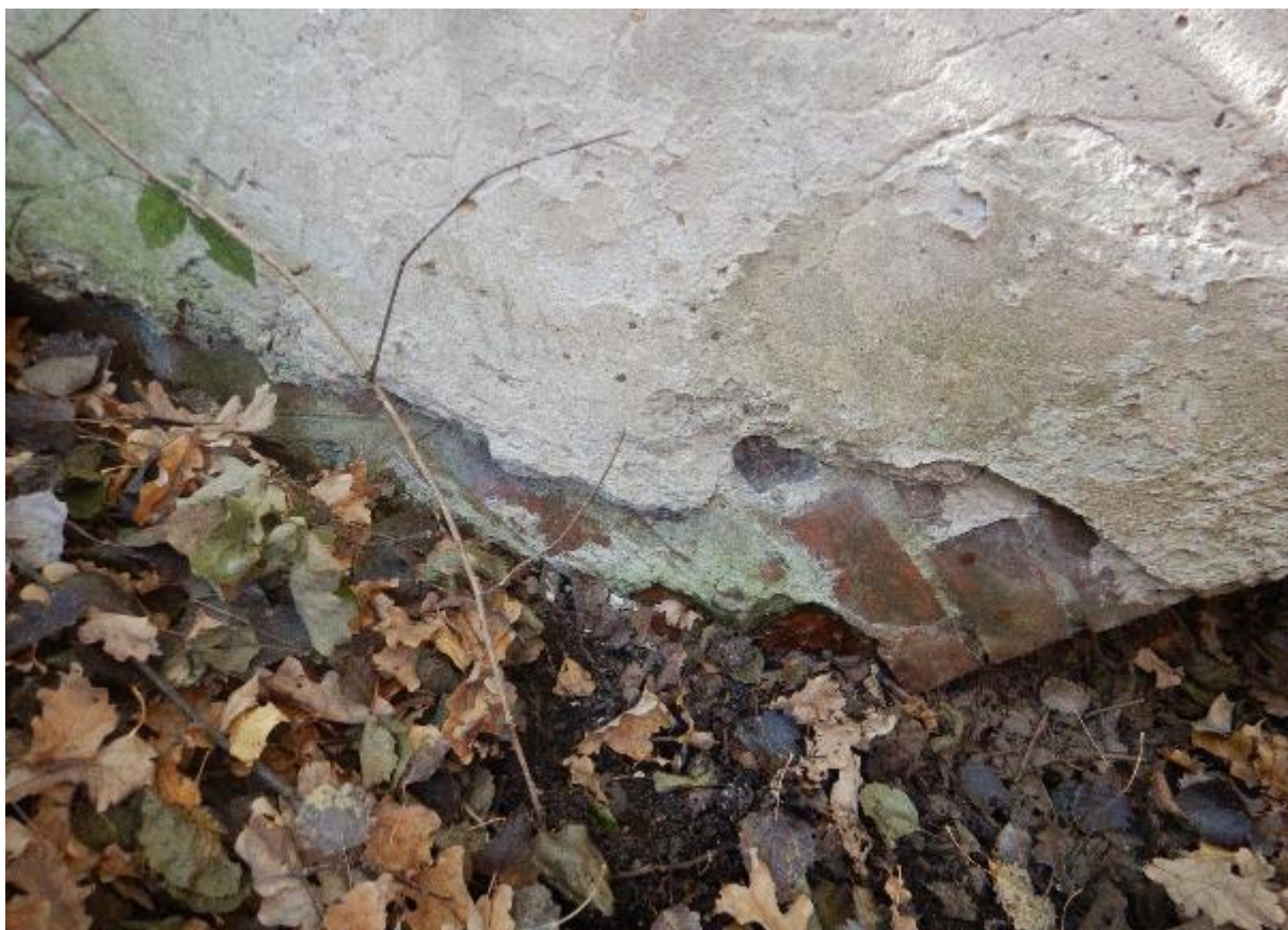
Zdj. 63 Widok na głowicę – ubytki tynku.
