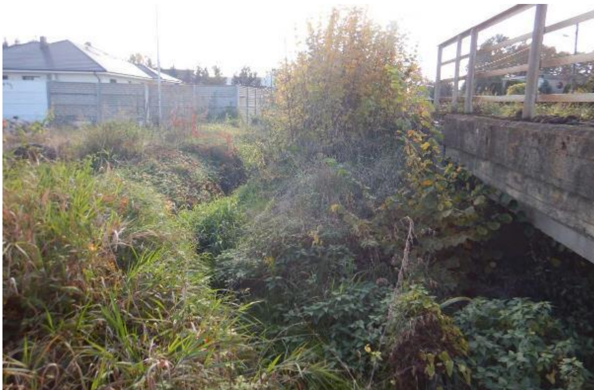
Zdj. 21 Widok na przeszkodę – wegetacja roślinności
